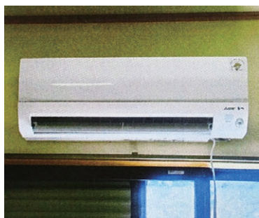
新たに整備されたエアコン
