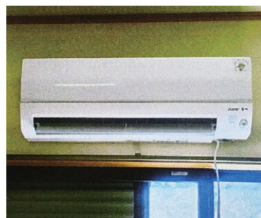
新たに整備されたエアコン
